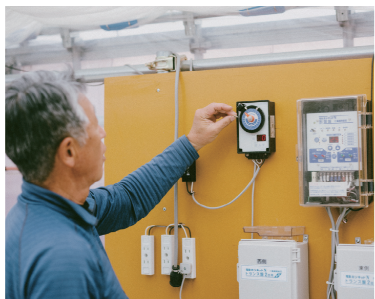
▲ハウス内に設置した操作盤で水や養液の制御を行います。簡便なシステムが気に入っています。
